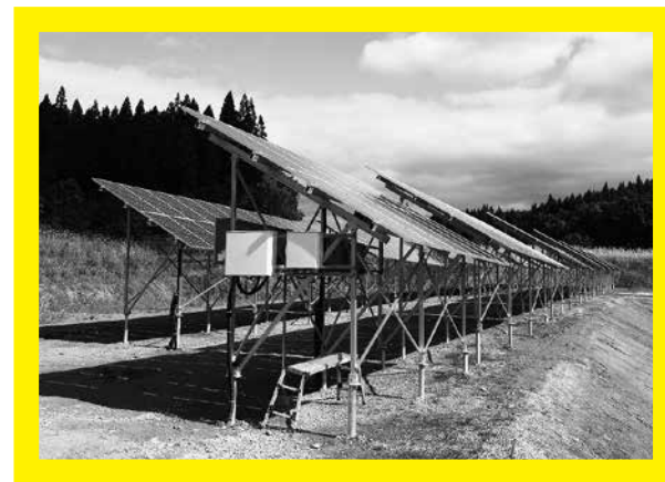
赤坂発電所 49.5kW、新庄市、もがみ自然エネルギー(株)
