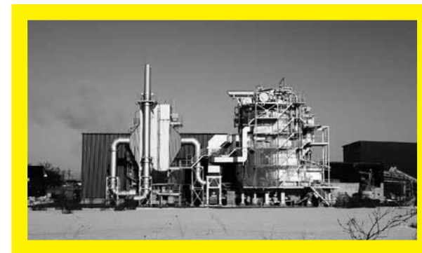
鶴岡バイオマス発電所 1,950kW
