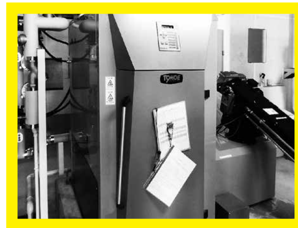
山形県森林研究研修センターペレットボイラ
